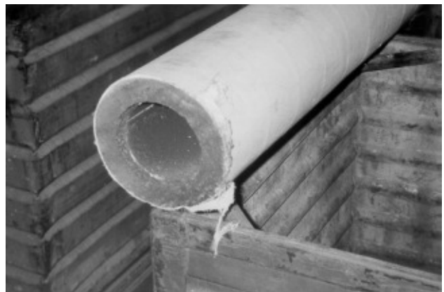
Calorifugeage contenant de l'amiante, photo IST
