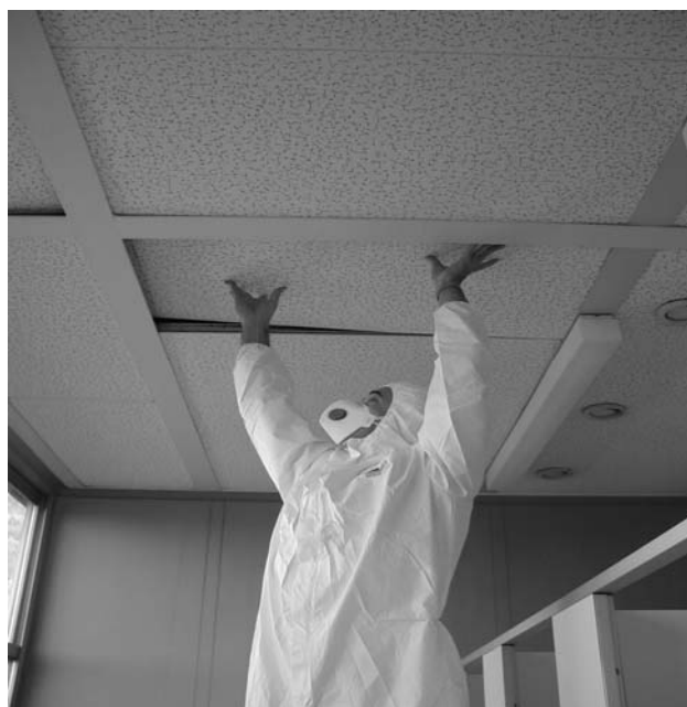
Faux plafond contenant de l'amiante, photo IST
